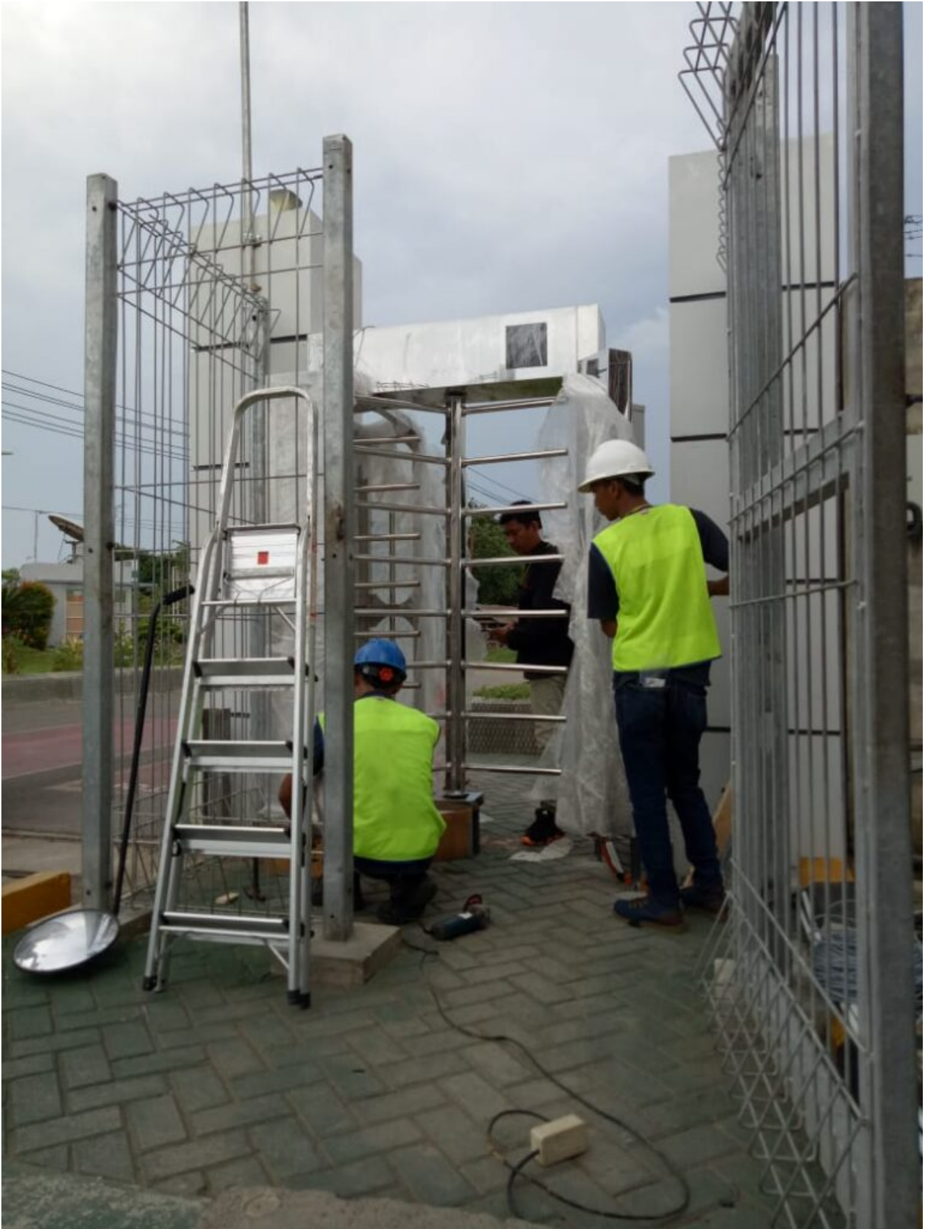
Distributor Terbaik Full Height MSM Parking Palang Parkir Cilacap, Pendahuluan MSM Parking Group, sebagai Distributor Terbaik , menyediakan
