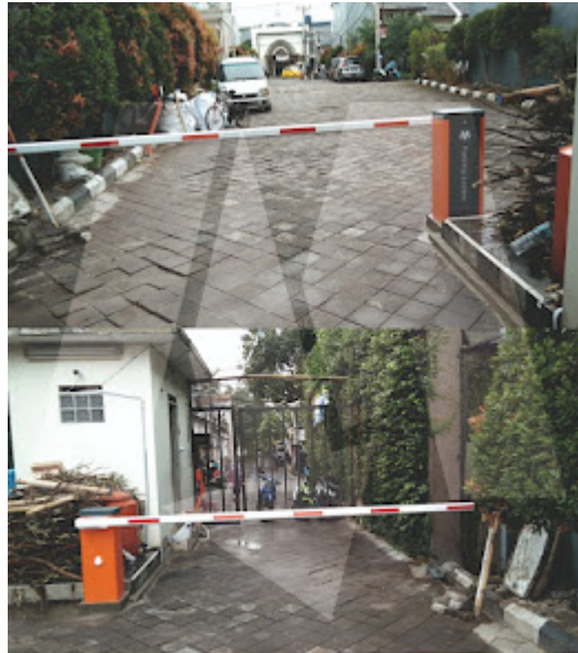
SYSTEM GATE : RFID ONLINE SYSTEM LOKASI PEMASANGAN : PERUMAHAN MY HOME UJUNG BERTING - BANDUNG
